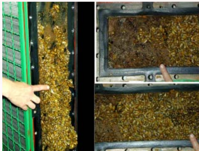
Figura 8: «Macrofouling» en la tapa e interior de un intercambiador de calor de una central hidroeléctrica. Fotos: Gustavo Darrigran.
