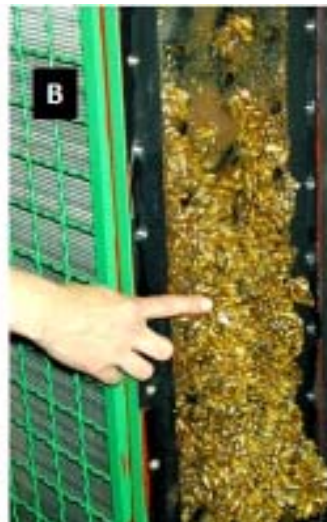
Figura 6: Ejemplares de Limnoperna fortunei , ocasionando «macrofouling» en: A Tomas de agua en plantas potabilizadoras de agua («parshall»), B Intercambiador de calor de una central hidroeléctrica. (imagen tomada por G. Darrigran).
